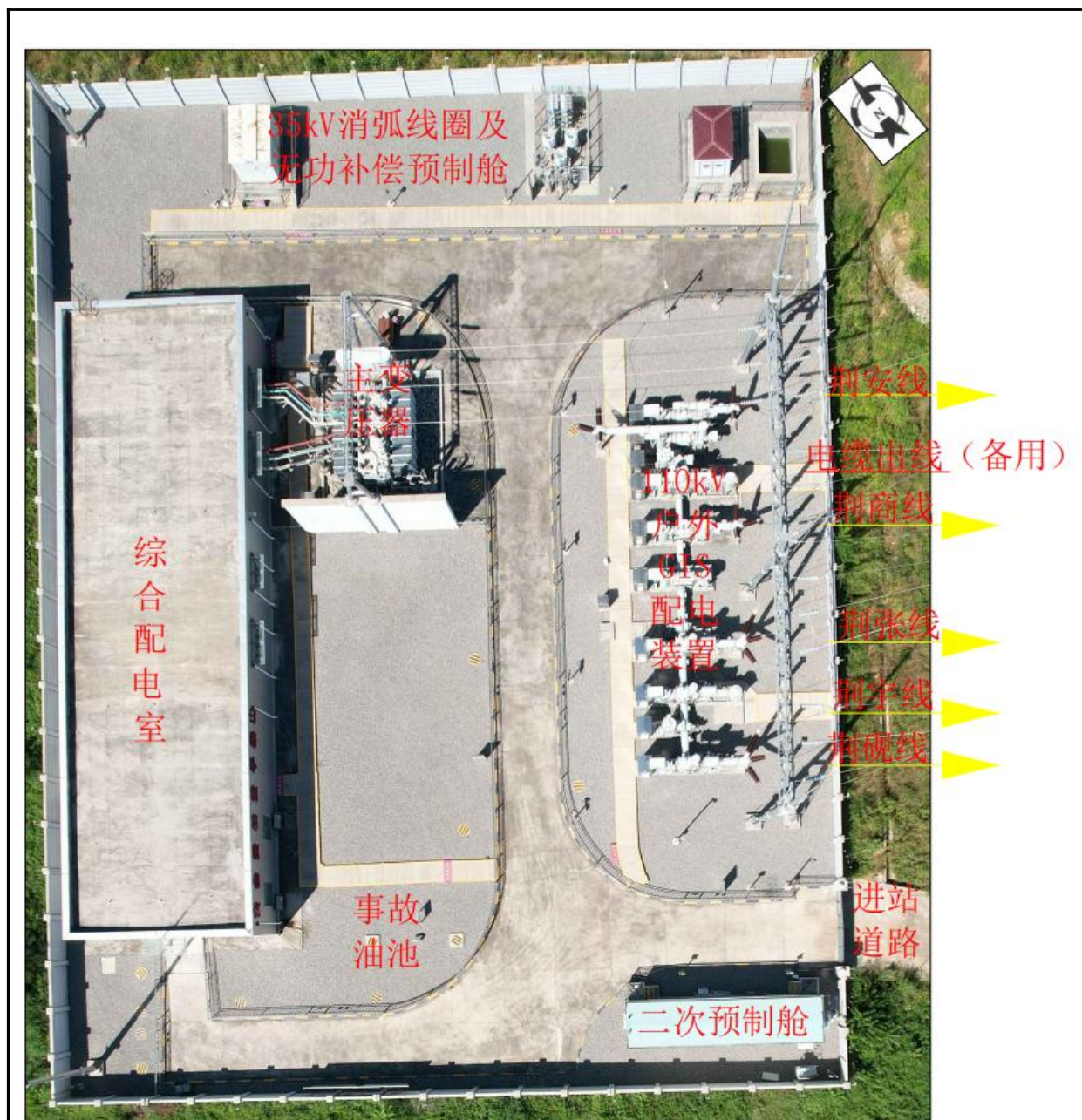
图 4-4 荆河 110kV 变电站航拍图
