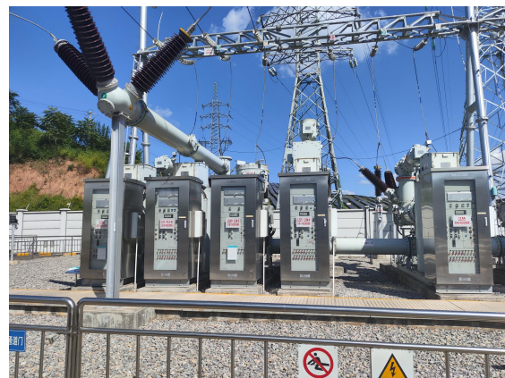
荆商线、荆安线出线
