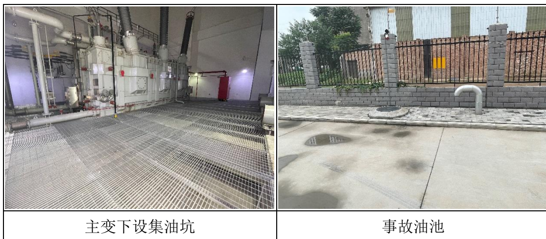
图 11-1 站内事故油池及主变油坑
