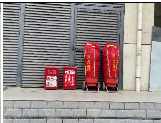
站内消防设施
