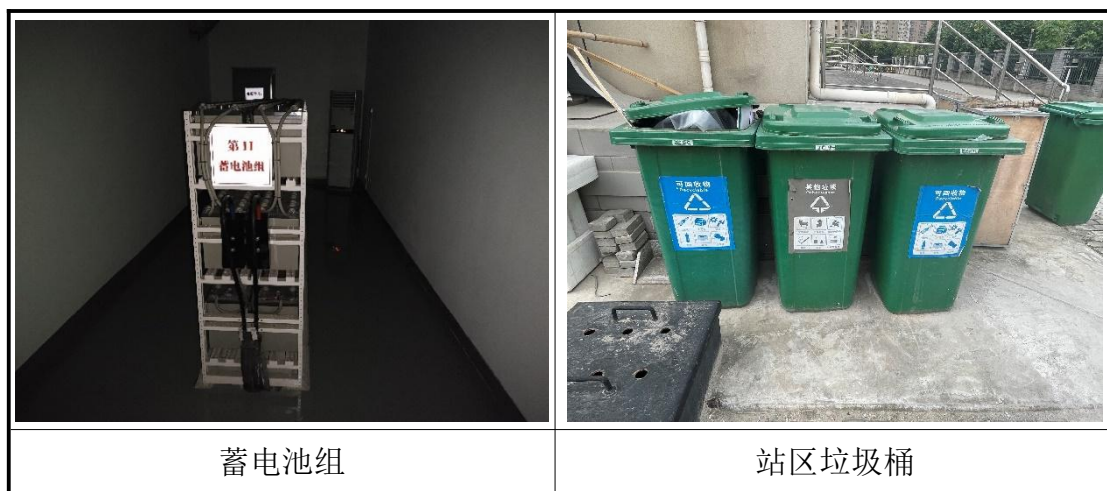
图 10.3-1 变电站站内照片
