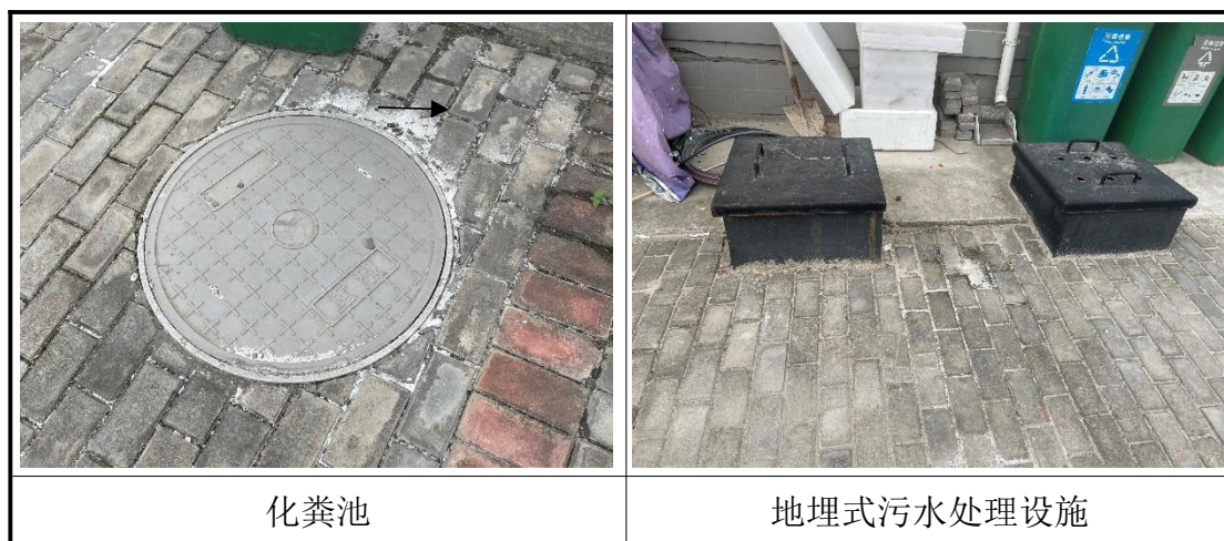
图 9.2-2 污水处理设施照片
