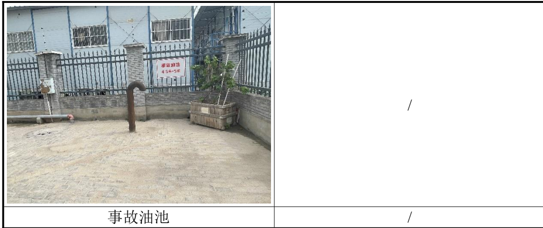
图 11.2-1 玄武 330kV 变电站事故油池和主变铭牌
