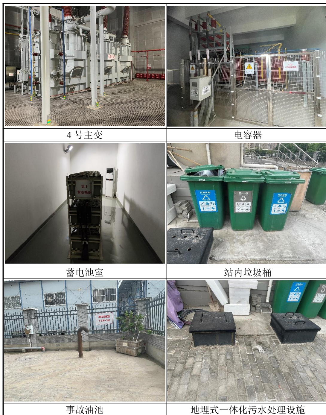
图 3.2-4 玄武 330kV 变电站主要建筑及设备情况
