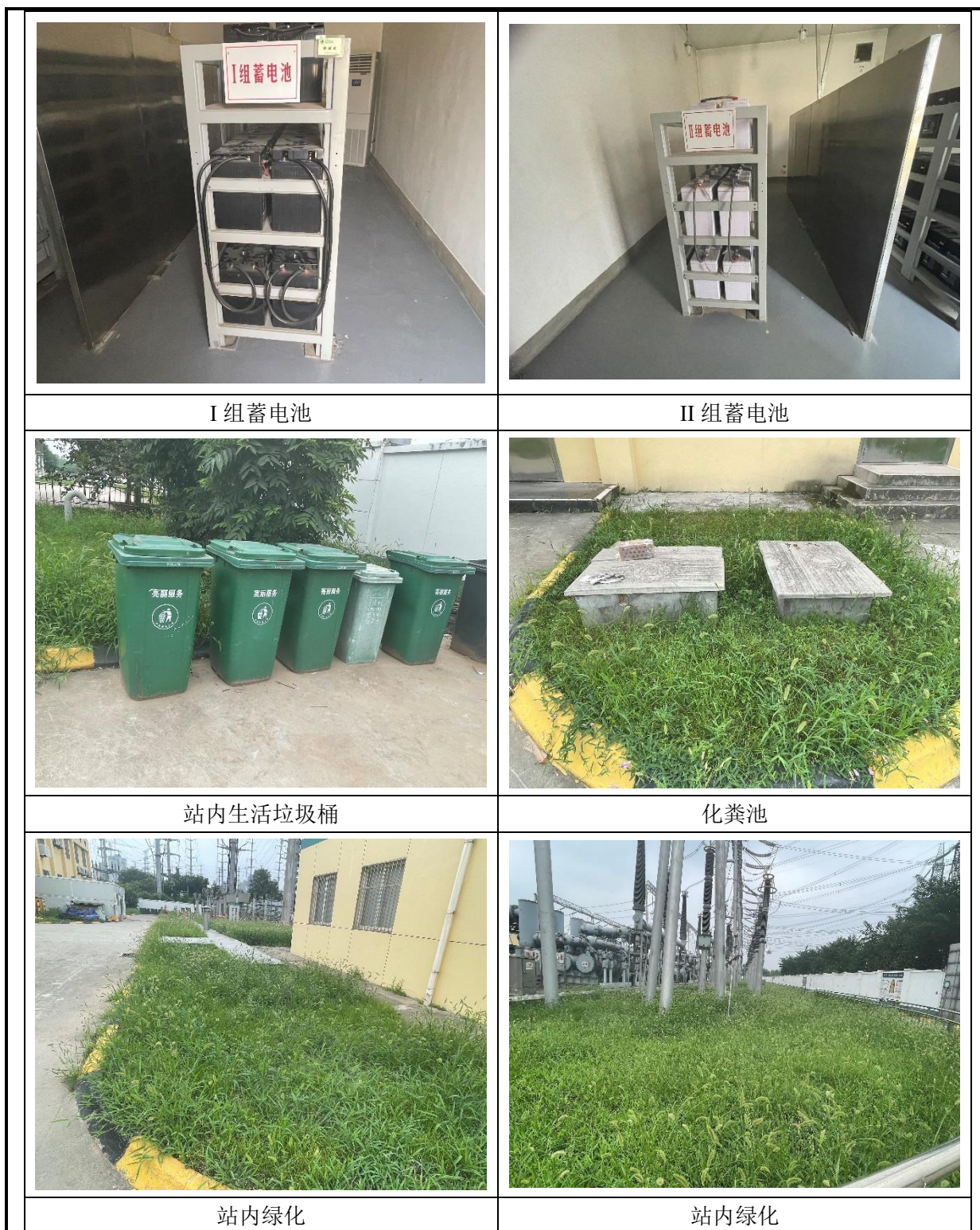
图 8-1 上苑 330kV 变电站现状照片
