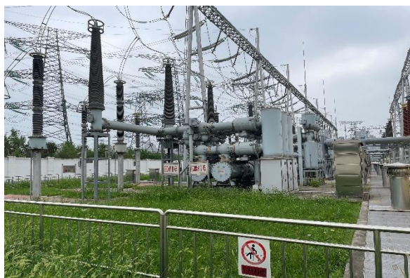
330kV GIS 设备区
