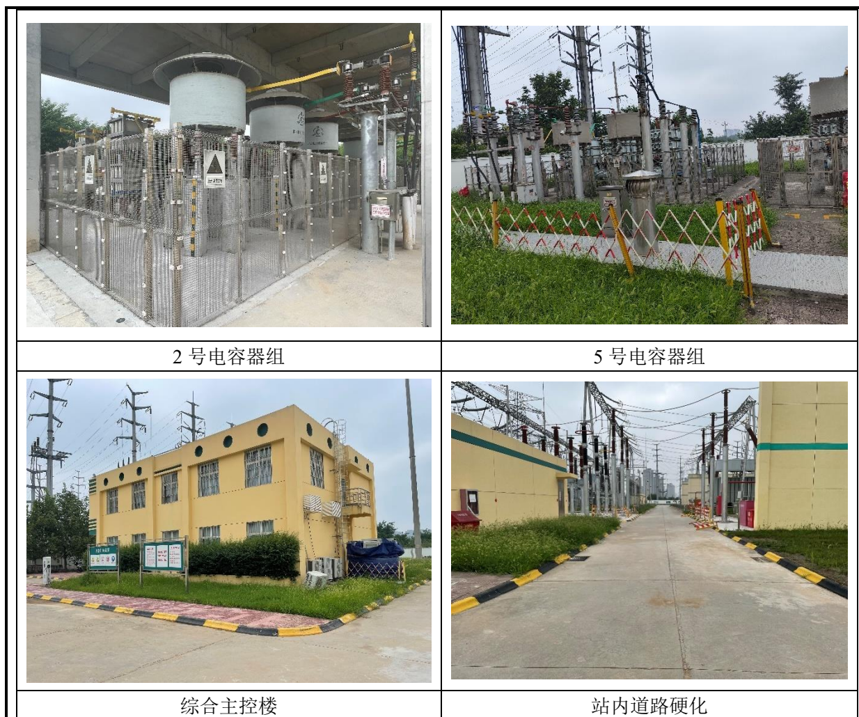
图 4-3 上苑 330kV 变电站主要设备
