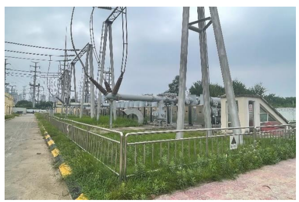
110kV GIS 设备区
