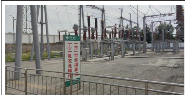
庄北 110kV 变电站本期新建间隔
