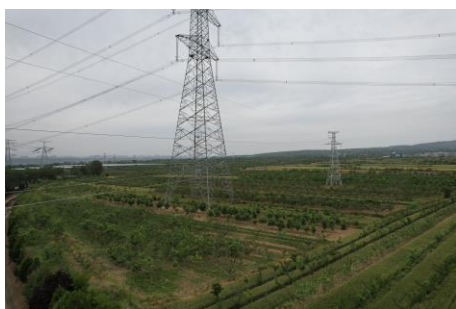
庄牵线与 750kV 线路钻越处
