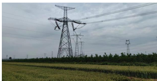
庄牵线与±1000kV 线路钻越处 ( )
