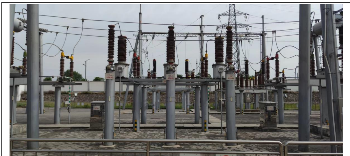
图 4-3 变电站间隔扩建实景图
