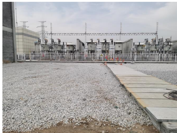
渭南北 330kV 变电站碎石覆盖 (2022 年 3 月)
