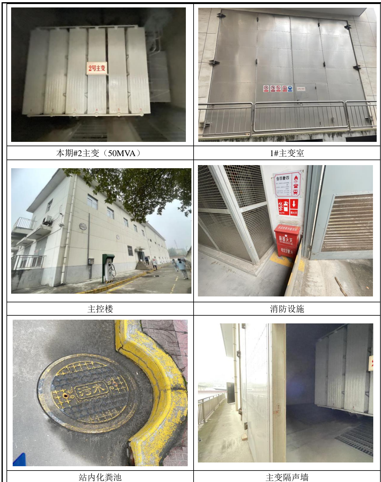
图 4-2 110kV 桃园路变电站周边环境情况及主要设备
