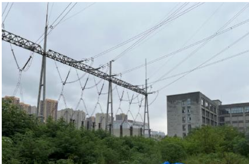
河寨330kV变电站扩建区
