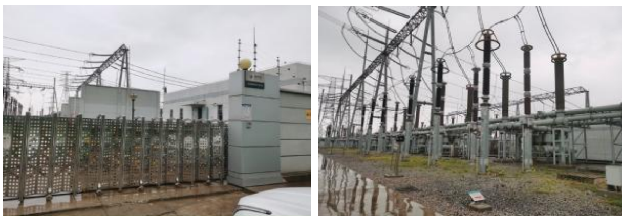
训善 330kV 变电站现状
