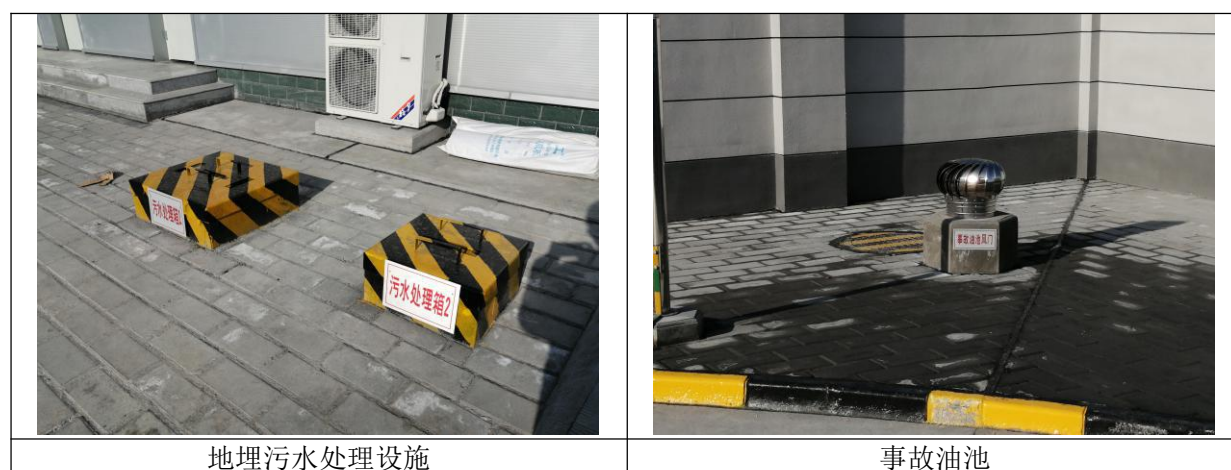
图 4-2 滨江 110kV 变电站站内环保设施照片
