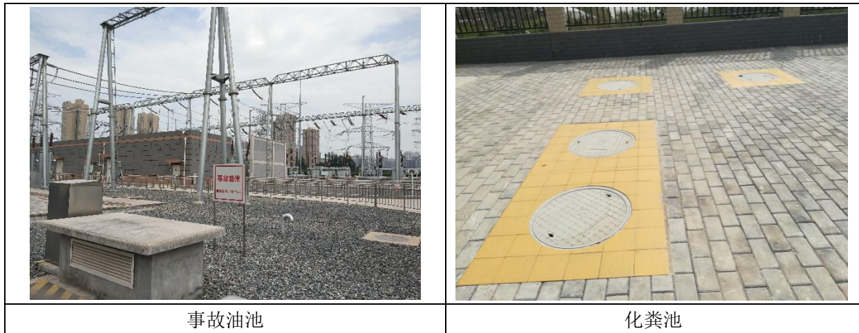
图 3.2-2 云谷 330kV 变电站现状照片
