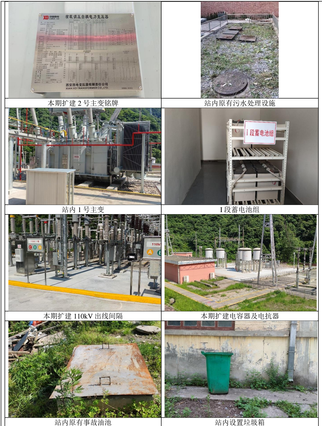
图 4-3 汤峪 330kV 变电站内照片
