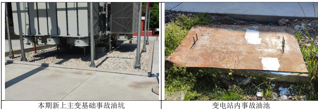
图 8-3 汤峪 330kV 变电站事故油坑、油池照片
