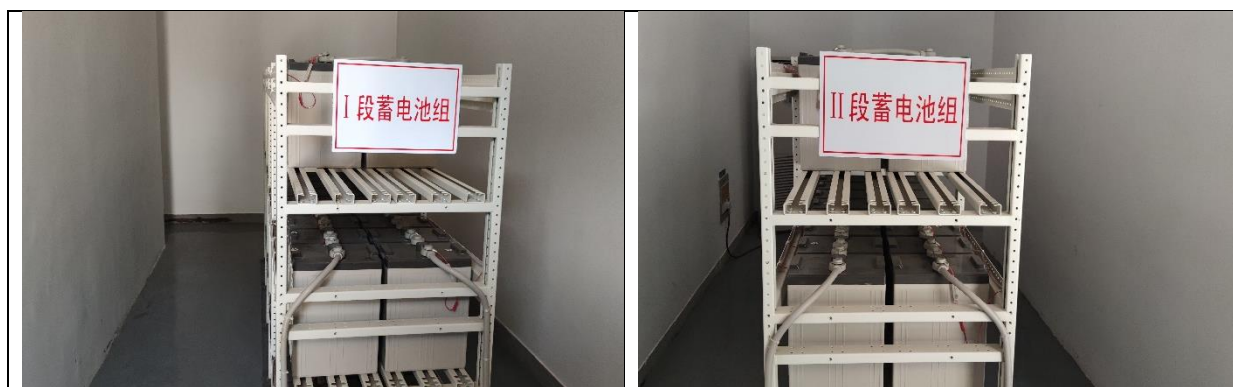
图 8-2 汤峪 330kV 变电站内蓄电池组（正常运行使用中）
