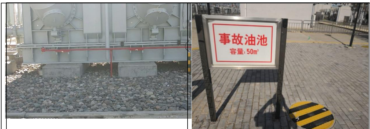
主变基础事故油坑
