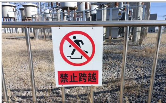
3#主变电容器组
