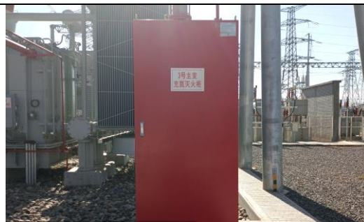
3#主变充氮灭火柜
