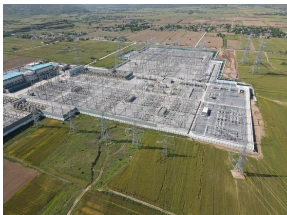
宝鸡 750kV 变电站
