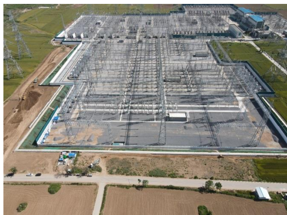
宝鸡 750kV 变电站
