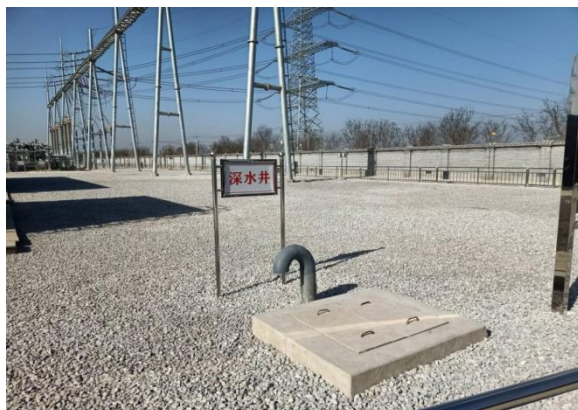
武镇 330kV 变电站站区碎石覆盖
