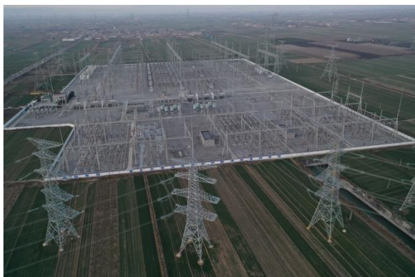
750kV 乾县变电站扩建区碎石覆盖
