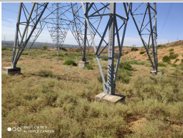
风沙区塔基绿化（云横 I 线 099）
