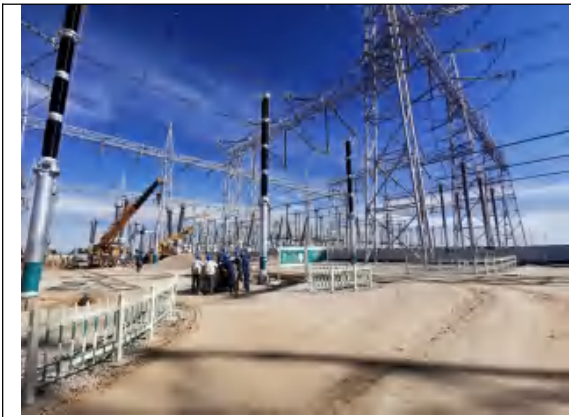
750kV 配电装置构架 (AIS)
