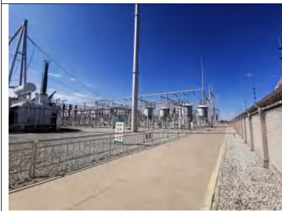
330kV 配电装置构架 (AIS)
