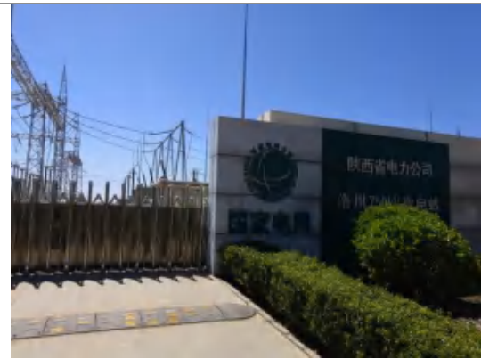
洛川 750kV 变电站
