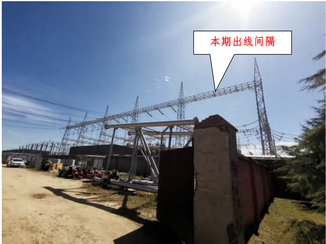
图3.12 洛川750kV变电站北侧出线间隔周围情况（现有及本期出线间隔）
