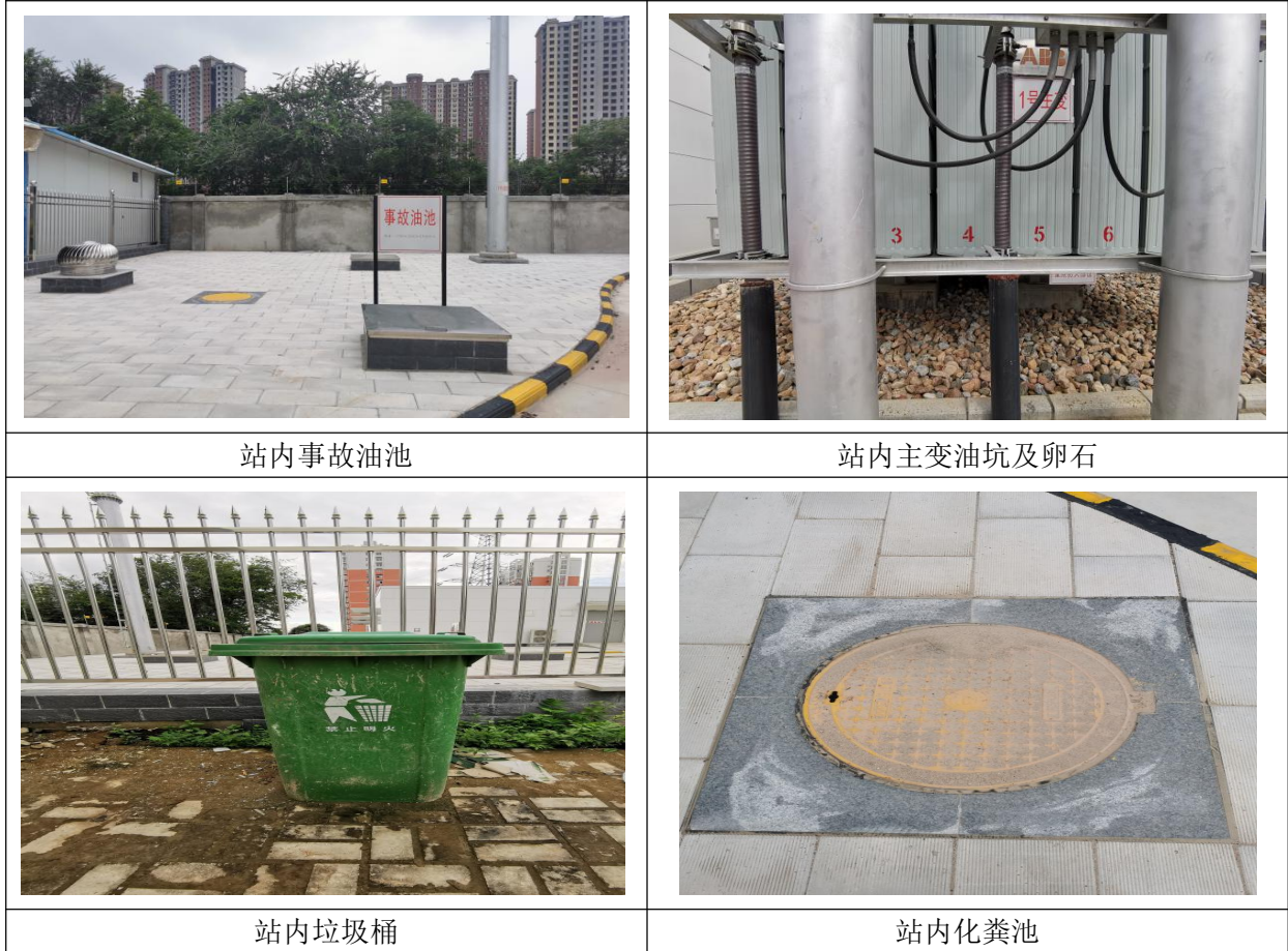
图 6-3 玉涧 110kV 变电站环保设施情况
