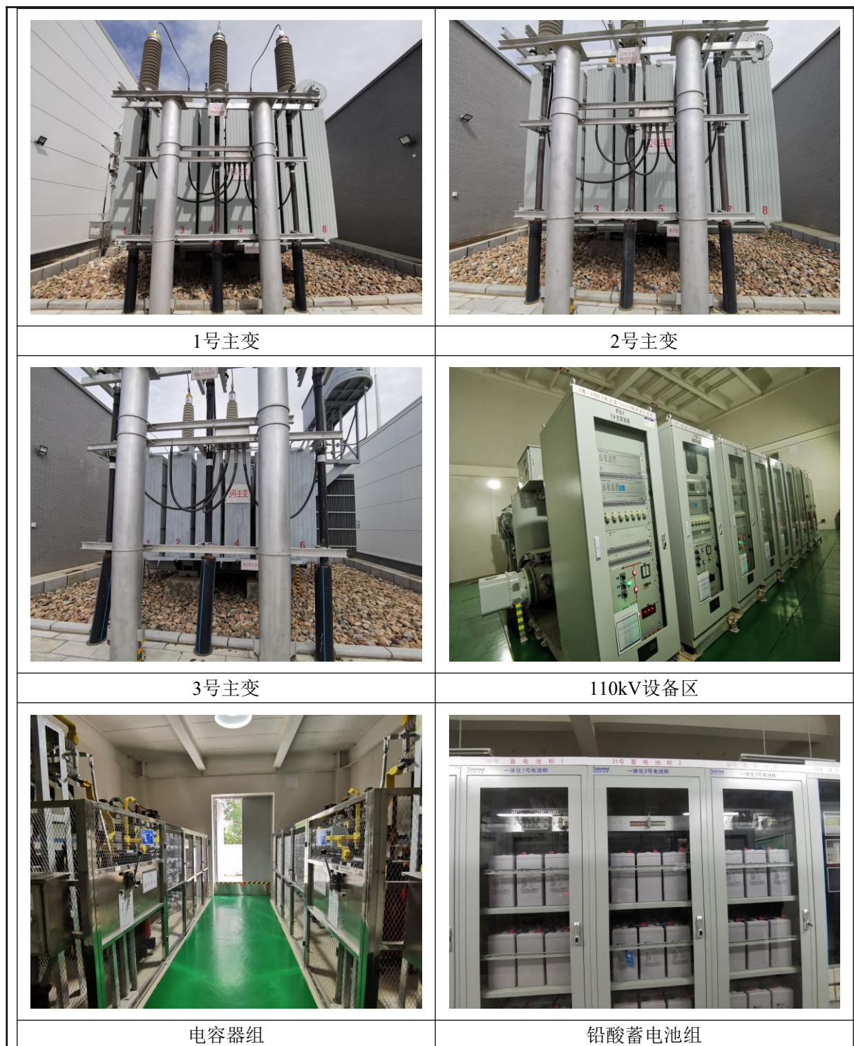
图 4-3 玉润 110kV 变电站站区照片
