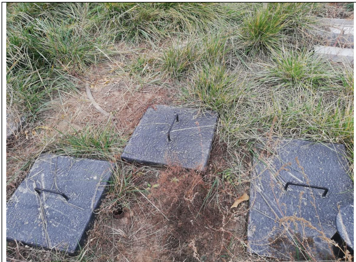
图 10.1-1 绥德 330kV 变电站内地埋式生活污水处理设备
