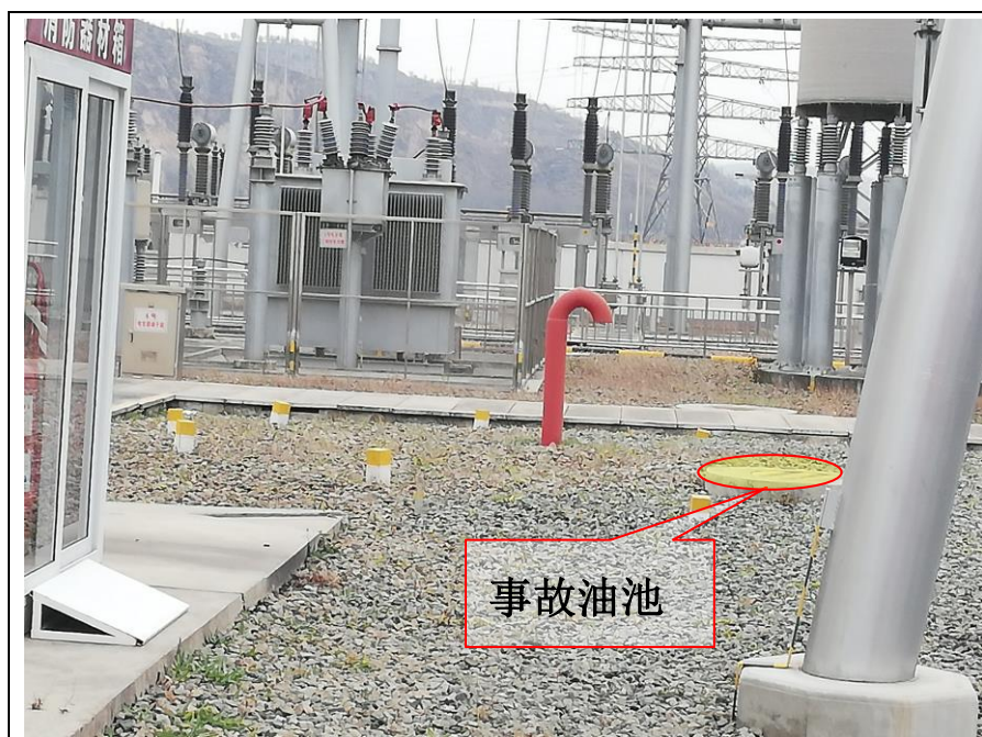
图 10.3-1 变电站原有事故油池
