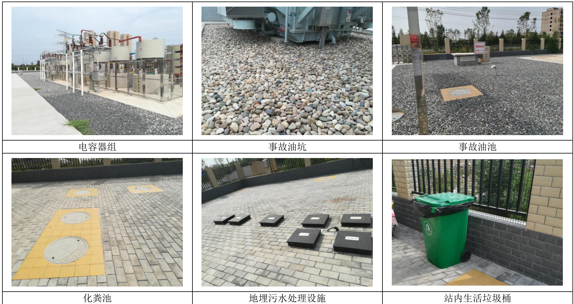
图 3.2-1 变电站内设备（设施）照片
