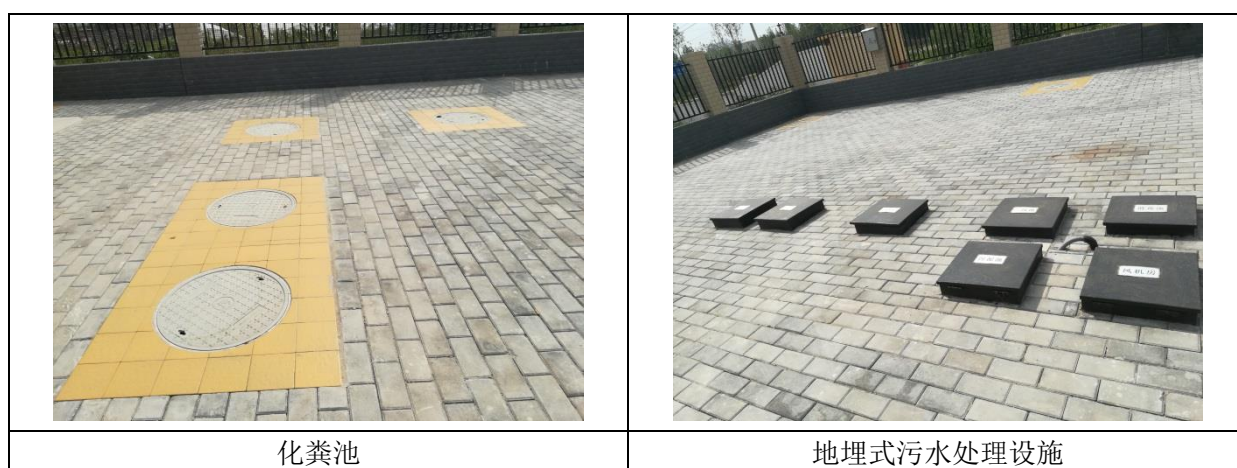
图 9.2-1 云谷 330kV 变电站污水处理设施照片
