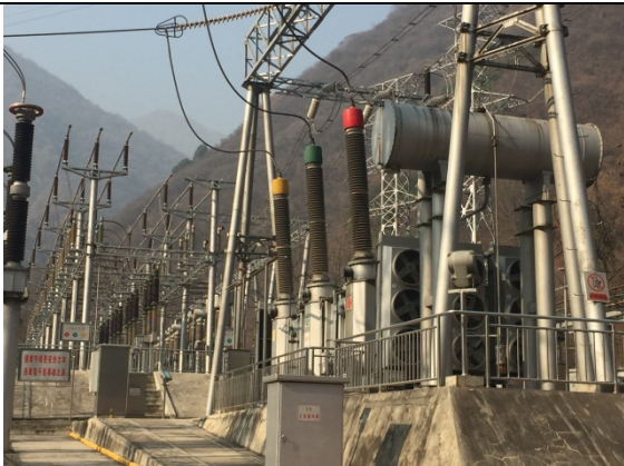
站内 1#主变及 110kV 构架区
