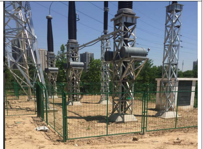
电缆终端下线塔
